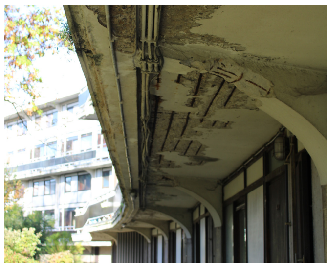
La réparation du béton de la façade extérieure est clairement une priorité.
